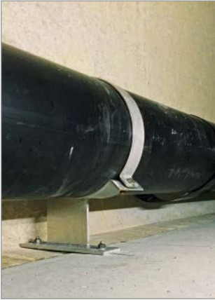
Bild 6: Befestigung der gedämmten Löschwasserleitung mit Standardrohrschellen
