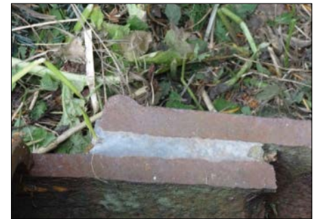
Bild 1.6: Aufgeschnittene Stemmuffen-Verbindung eines etwa 300 Jahre alten Gussrohres – Versorgungsleitung für die Wasserspiele des Schlossparks Kassel-Wilhelmhöhe mit dem Herkules-Denkmal; Weltkulturerbe der UNESCO seit Juni 2013 Quelle: mhk, Museumslandschaft Hessen Kassel
