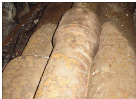
Bild 1.3: Gussrohrleitung zur Versorgung der Wasserspiele des Herkules-Denkmal mit Wasser im Schlosspark Kassel-Wilhelmshöhe (UNESCO-Welterbe seit Juni 2013)
